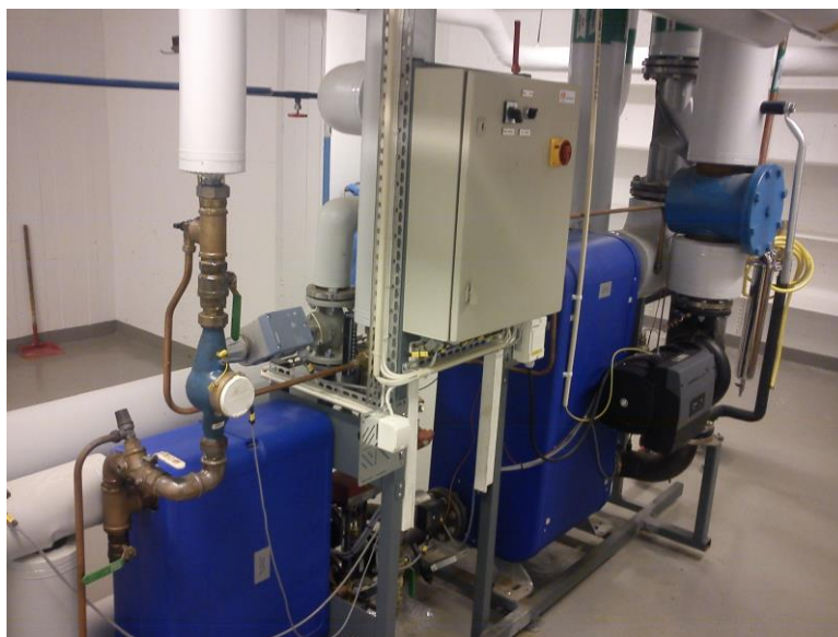
Source : AMORCE, Photo d'une sous-station de chauffage urbain
