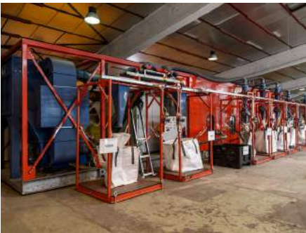
Fig 25. Usine de recyclage des modules photovoltaïques cristallins – Rousset, France – © Veolia & PVCYCLE
