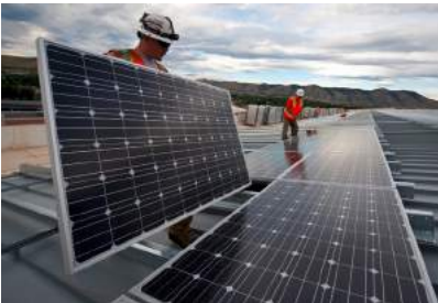
Fig 18. Exemple d'installation photovoltaïque en surimposition de toiture (Pxhere)
