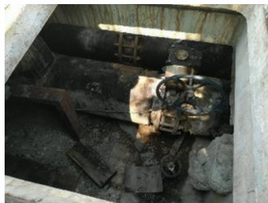
Illustration 1: Exemple de corrosion externe en caniveau sur le réseau Hauts de Garonne. Les corrosions externes attaquent d'abord les parties les plus froides : supports de tuyauterie, réseau retour plus froid...
