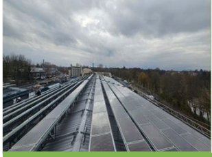
Fernwärme Teltow (DE)
