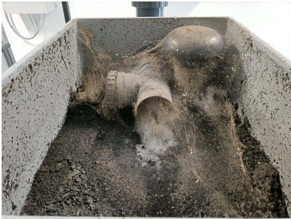
Accumulation de moucheron dans le préfiltre
