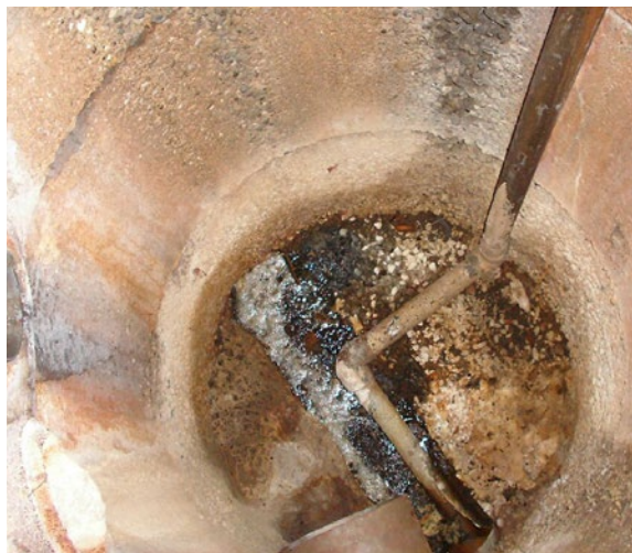
Corrosion dans un regard, liée à un effluent acide et de température élevée
