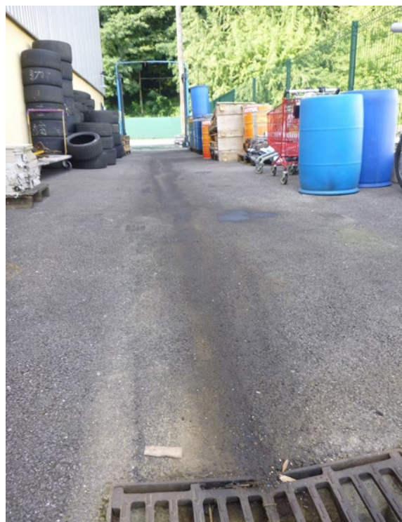
Exemple d'une aire de stockage problématique : l'aire est à ciel ouvert et ses avaloirs ne sont pas séparés du réseau de collecte général des eaux pluviales
