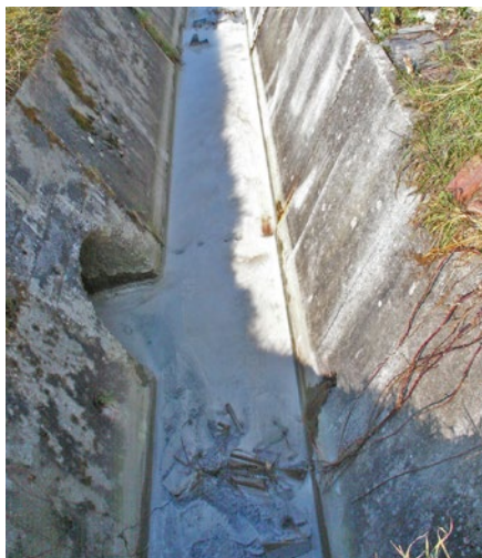
Rejet de laitance de peinture dans le réseau de collecte des eaux pluviales
