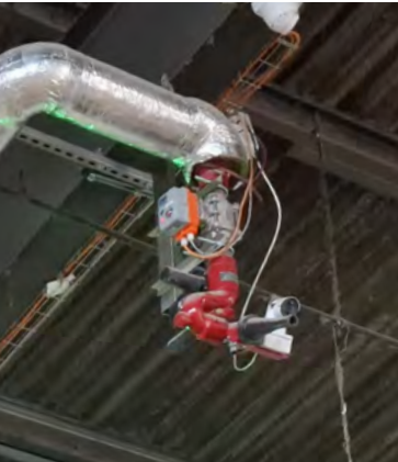
FireRover installé au centre de tri.
