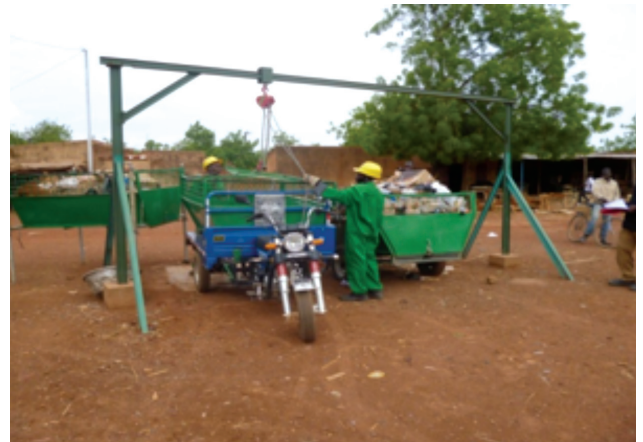
Les OC ont été très actives dans le test des équipements
