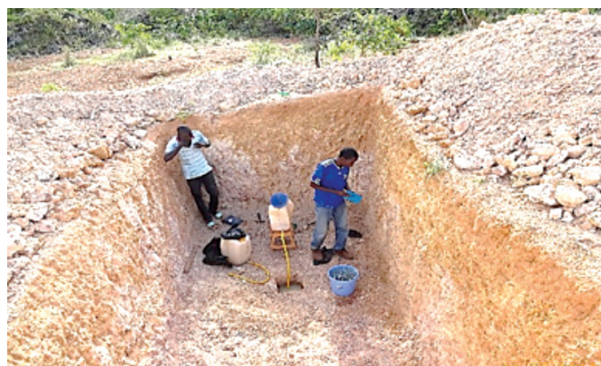
PHOTO 2 : Réalisation test de perméabilité lors de l'étude pédologique pour la réalisation de la décharge a PO
